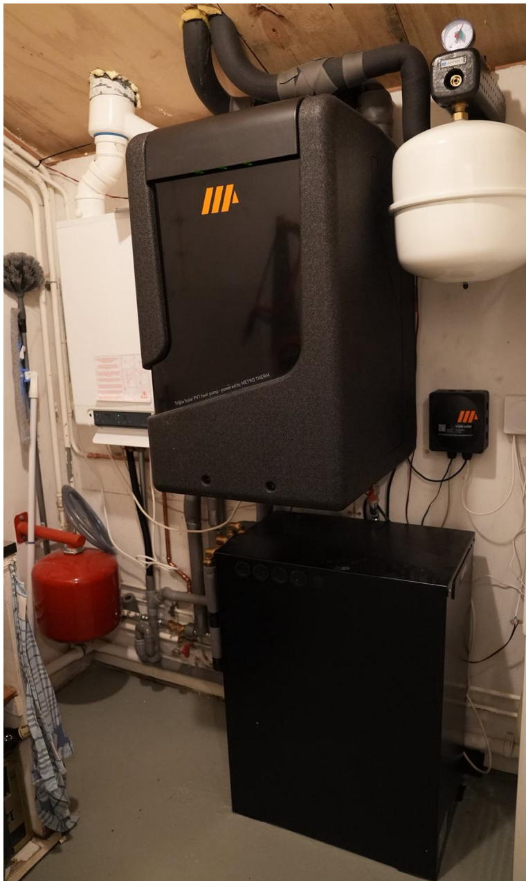
PVT-Warmtepomp met Warmtebatterij (3 e adres)
