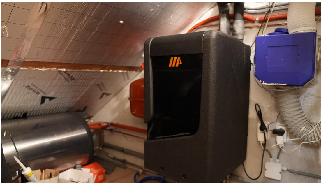
PVT-Warmtepomp met liggende boiler (links)
